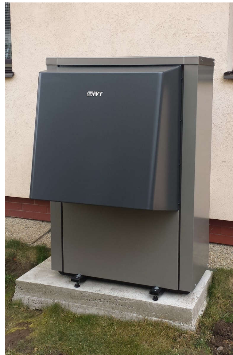
Dodatečně instalovaný protihlukový kryt
